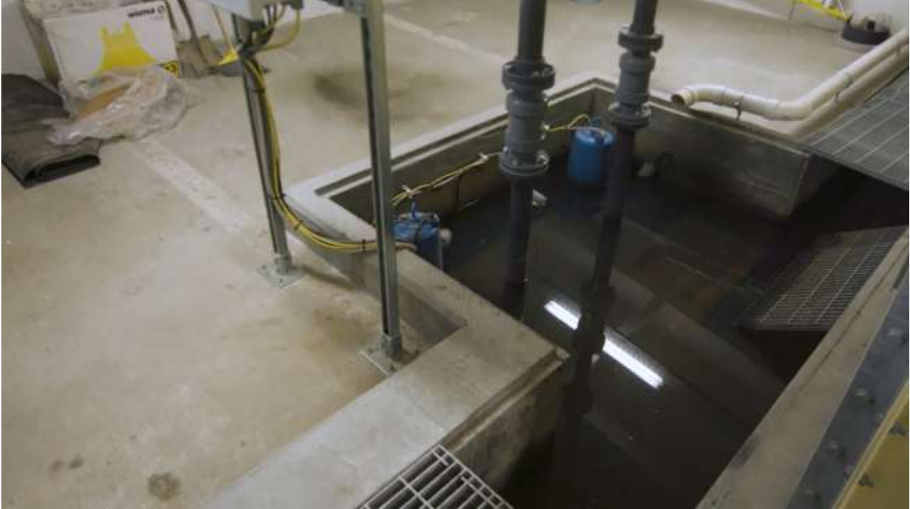
الشكل: (10) تجميع المياه الواردة من الأسطح
