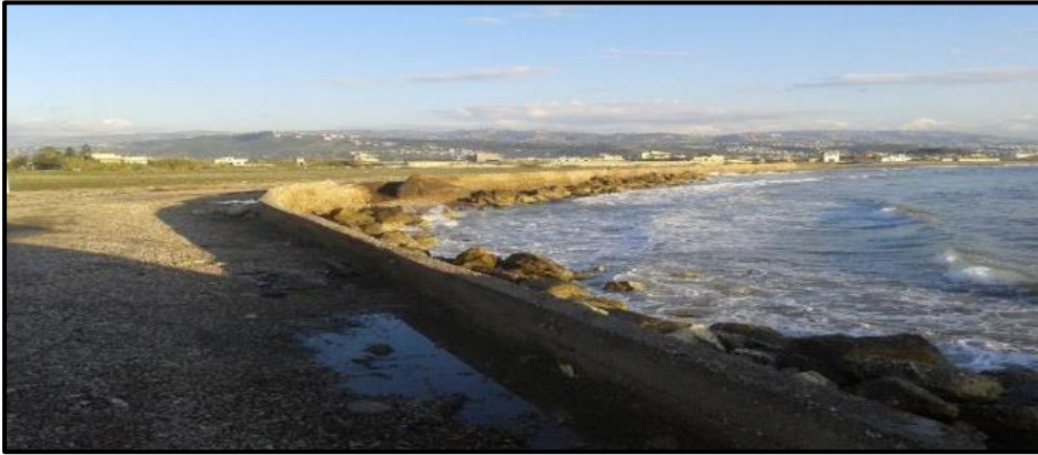
شكل (18) الحاجز الخرساني في منطقة خراب بلدة (عرب الملك)
